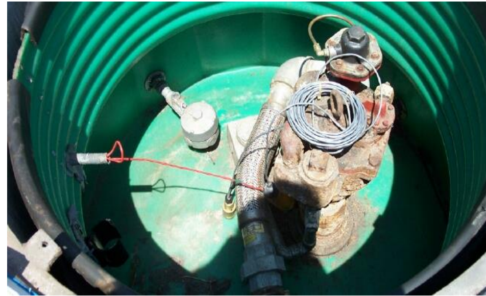
Unsealed electrical conduits
